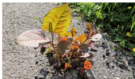
Infrastrukturschäden: Japanknöterich sprengt Asphalt.
