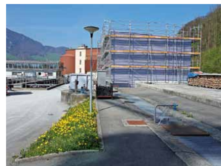
Rechts der neue Gasspeicher.
